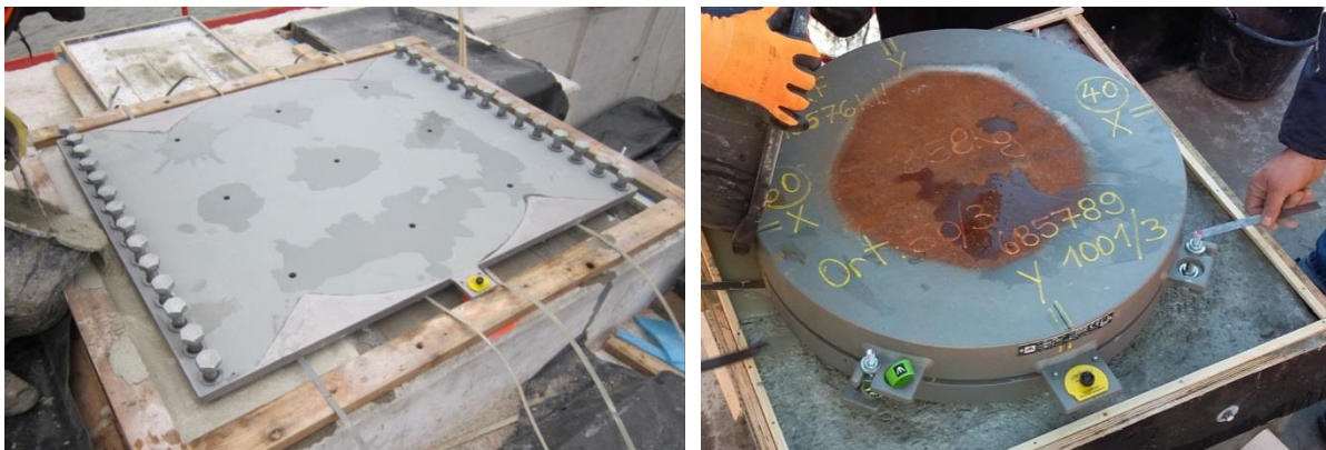
Abbildung 10: Lagerunterguss, Ankerplatte mit Luftauslassbohrungen (links) und Kalottenfestlager (rechts)
