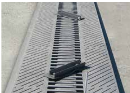
Soldadas, sin mantenimiento
