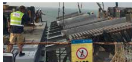
Instalación de juntas de dilatación de celosía deslizantes de MAURER en la estructura
