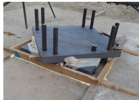
Eingebautes SIP®-D-Lager mit Betonierschutz.
