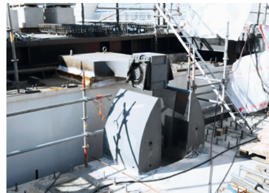
Horizontalkraftlager mit liegendem Vertikal-Pin. Darunter die 15 t schwere und ca. 1,8 m hohe „Klammer“, in die der Pin von oben einfährt. 2 Kalottenlager an der Spitze des Pins nehmen Verdrehungen auf.
