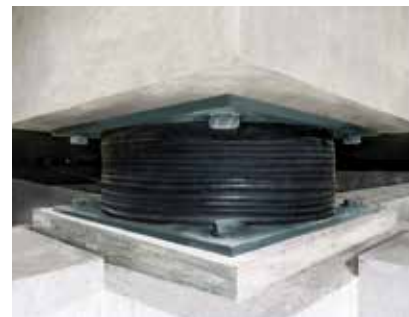
Eines der 243 Bleikernelager zwischen der oberen Betonplattform und der unteren Betonwanne. Gut zu sehen die ringförmigen Verformungen des Elastomers aufgrund der Elastomer-Stahlblech-Schichtung.
